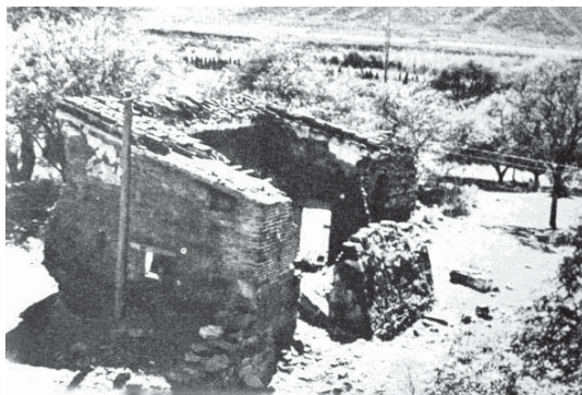
Figura 5: Una de las construcciones del casco de la estancia en pleno proceso de deterioro pero con paredes aun en pie en la década de 1950
