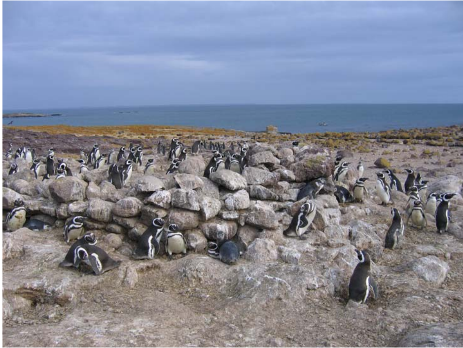
Construcciones hechas por la Armada en el siglo XX con piedras redondas sin escuadrar.
